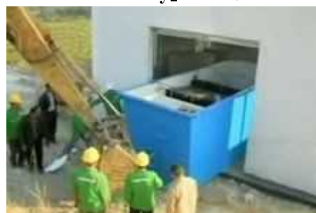
図 56: Shangba 村に設置された「Water Boy」システム
